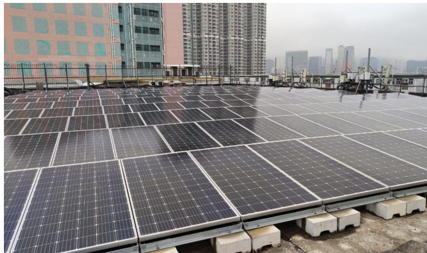
環凱廣場的太陽能光伏板
